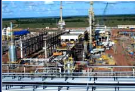
Cacimbas - Petrobras Cacimbas - Petrobras
