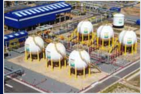
Cacimbas - Petrobras Cacimbas - Petrobras
