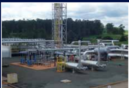
Estação de Compressão de Paulínea - TBG - Transportadora Brasileira Gasoduto Bolívia- Brasil (SP)
